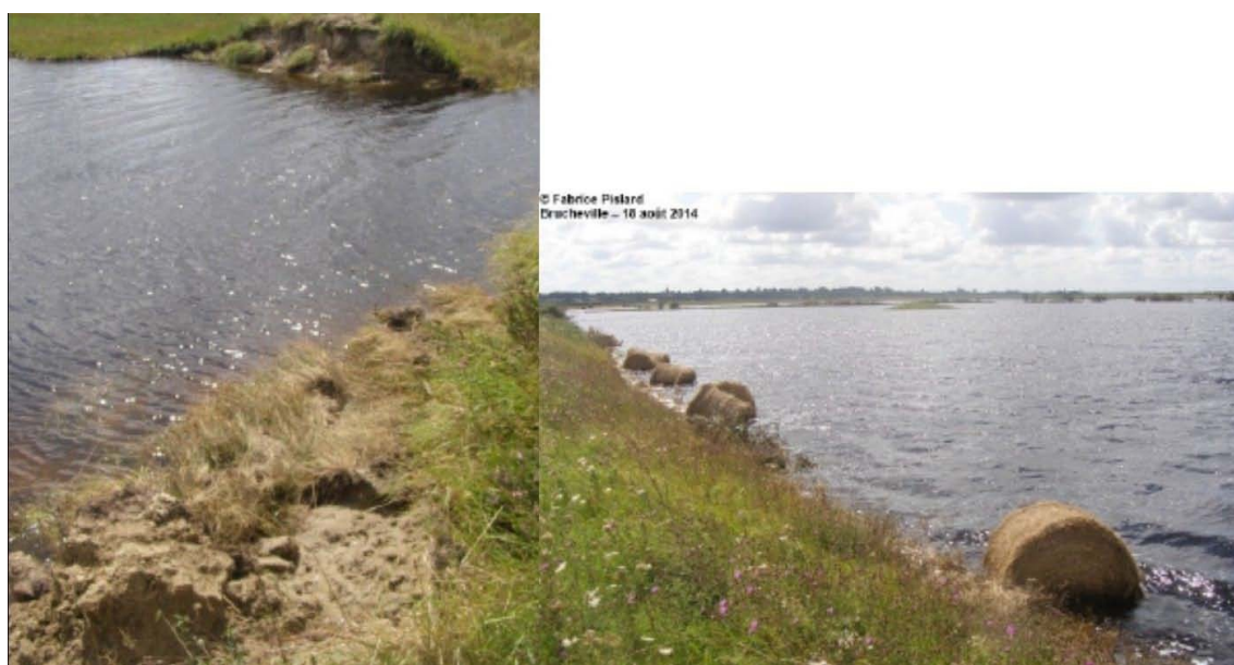
Figure 21: Photos de la brèche (gauche) et du polder (droite) durant la visite de terrain le 18 août 2014, cinq jours après la grande marée. Niveau de crête de l'ordre de 4,5 m IGN
