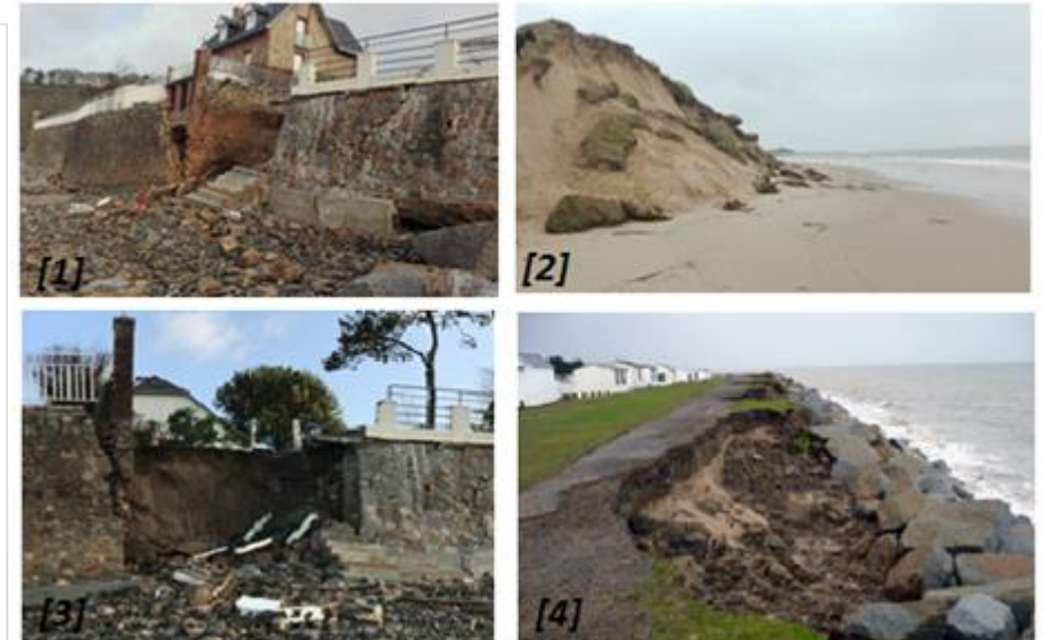
03/01/2018 à Saint-Jean-le-Thomas: 7 mètres de dunes partis à la mer [2], la destruction partielle de l'enrochement [4], endommagement de la cale et les murs de soutènements de la villa de Dunes effondrés [1][3].
