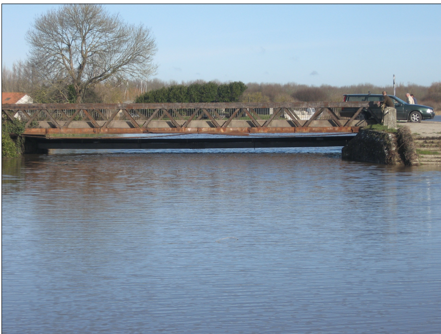
Figure 17: Niveau marin élevé au niveau du pont de la rue Giesmard, vue vers l'aval, le 2 mars 2010
