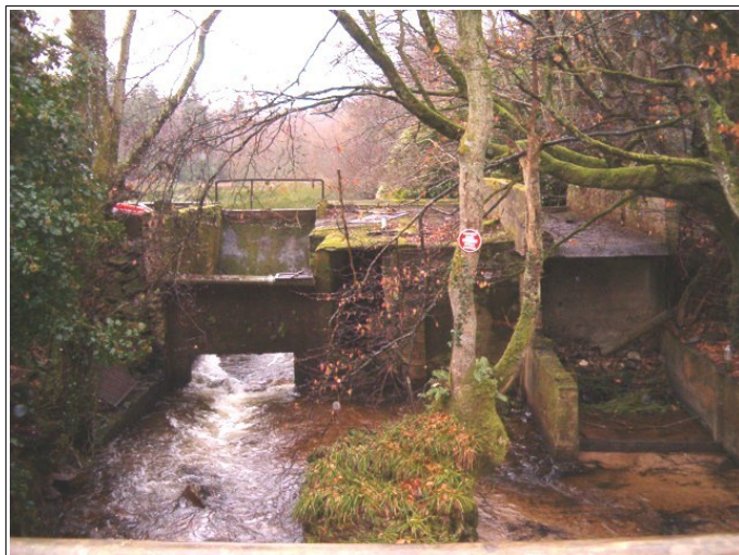
Photo 21: vidange du barrage du Moulin de la Banque empruntée par le Trottebec.
