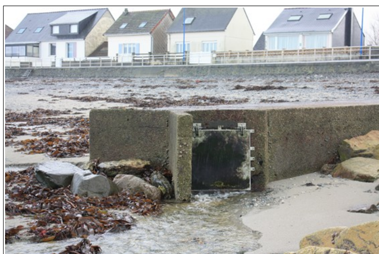
Photo 14 : portes à clapet de l'exutoire de la Digue à Urville-Nacqueville.
