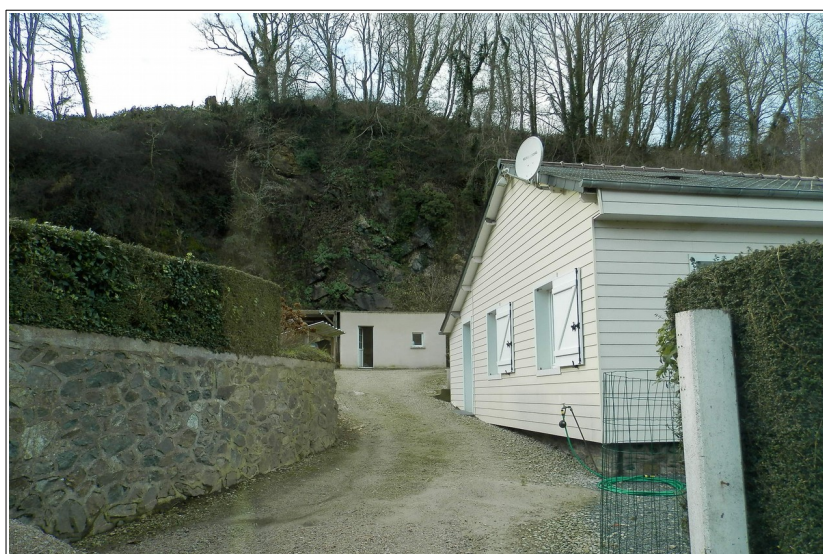
figure 98 : vue de l'affleurement rocheux dominant une propriété de la vallée de La Bialle (2 sur l'extrait de carte). On notera la remise collée à la falaise d'où peuvent se détacher des blocs.
