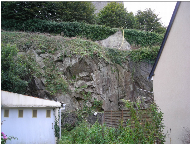
figure 87 : Talus rocheux le long de la rue du Général De-Gaulle générant quelques chutes de blocs inquiétant la commune de Tourlaville.
