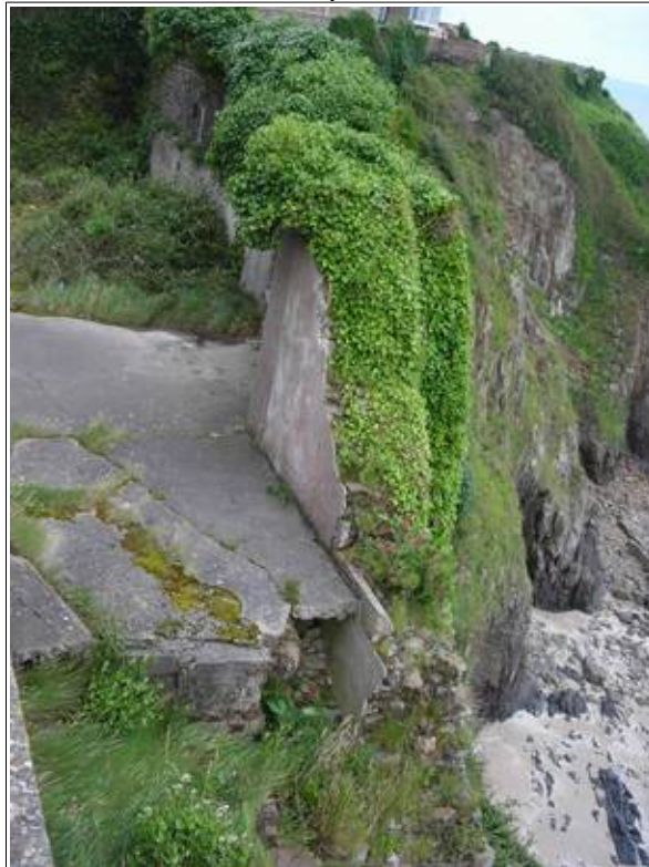
15 : commune de GRANVILLE , non loin du site précédent, des traces plus anciennes d'éboulement
