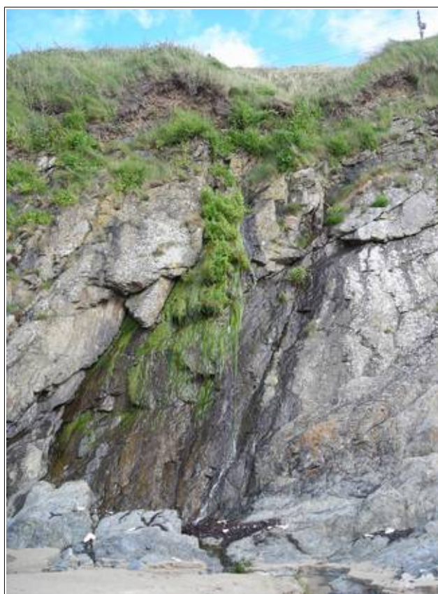
6 : commune de DONVILLE-LES-BAINS, venues d'eau importantes au niveau d'une faille à l'aval de la rue de LA DOUANE (eau de source). Les résurgences sont nombreuses le long de la cote rocheuse. L'état très fracturé du rocher favorise la présence d'un aquifère de type fissural. L'eau joue un rôle moteur et déclencheur dans les déstabilisations de terrain, en accélérant les processus d'altération des matériaux, en provoquant des mise en charge, en favorisant les glissements plan sur plan, etc.
