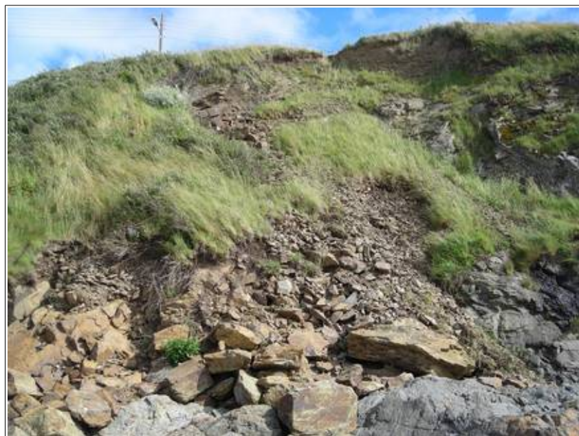
5 : commune de DONVILLE-LES-BAINS, vue du talus aval de la rue de LA DOUANE depuis la plage ; le petit éboulis et l'arrachement visible au sommet du talus témoignent des mouvements de terrain actifs affectant la cote rocheuse.
