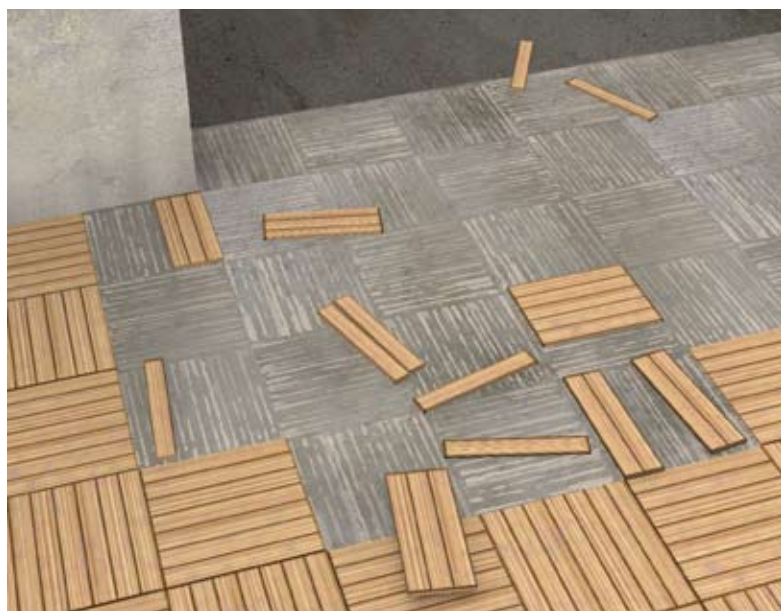
Décollement généralisé d'un parquet mosaïque collé sur béton.
