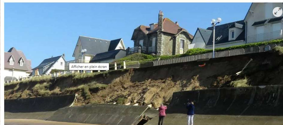
La digue a été fragilisée sur une centaine de mètres | OUEST-FRANCE
