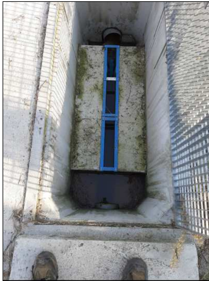
Figure 20 : vue du canal venturi implanté en entrée de station d'épuration.
