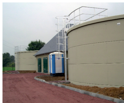
Station de pompage à Auvers
