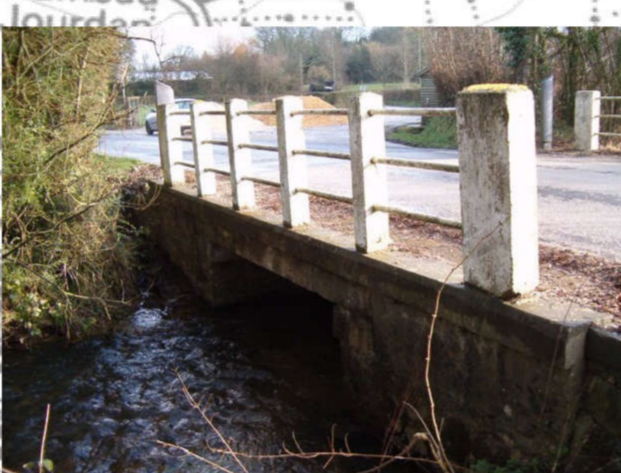
Photo 14 : Débordement régulier sur la RD 507 jusqu'à 20 cm d'eau sur la chaussée
