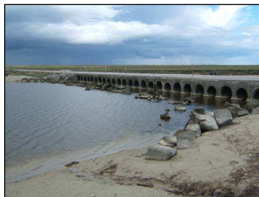
Figure 38 : Vue sur la route submersible – Lieu de prélèvement de “La Vanlée”
