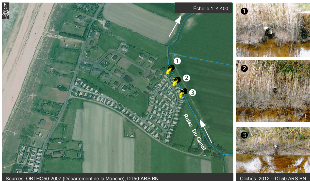
Figure 65 : Localisation des drains d'écoulement issus du camping du Grand Large (DT50-ARS BN)
