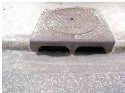
Photo 26 - Avaloir pluvial rue de la Galouette
