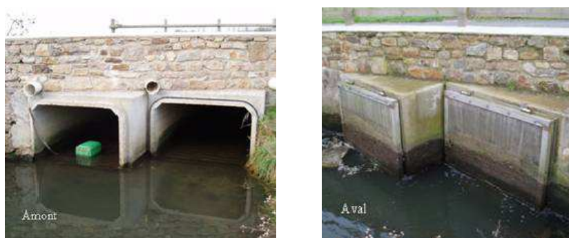
Figure 37 : Vue sur les portes à flot avant rejet dans la Saire (Illustrations issues de l'étude SOGREAH, 2006)
