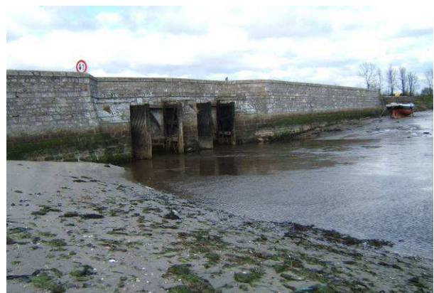
Figure 23 : Vue sur les portes à flots à l'embouchure de la Saïre
